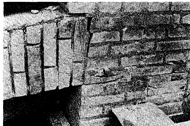
Fig. 4. Murbjælke af armeret murværk. Revne i overside af vederlag ved 10 t belastning.
